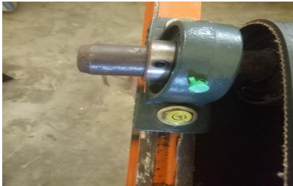
Gambar 4. 3 Rangka dudukan bearing dan setelan roller
