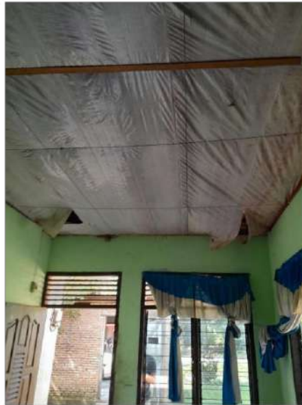
(c). Kondisi plafon kotor dan sulit dibersihkan
