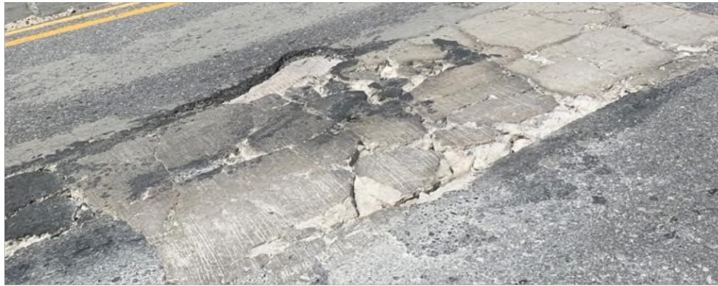
Gambar 4.17. Jalan Berlubang di Desa Rimbo Panjang Sumber : Dokumentasi pribadi
