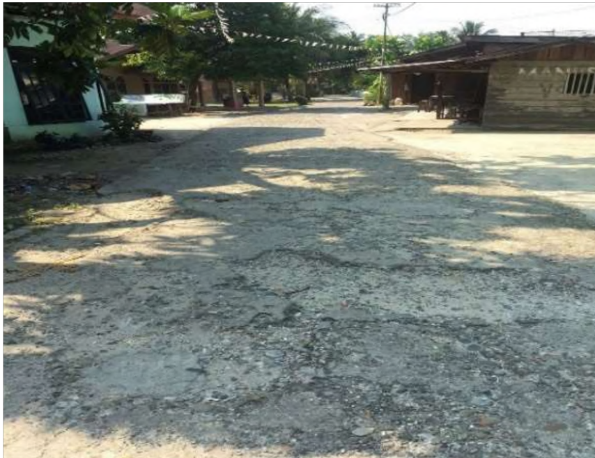
Gambar 4. 2 Kerusakan Jalan Rona ( dokumentasi lapangan )
