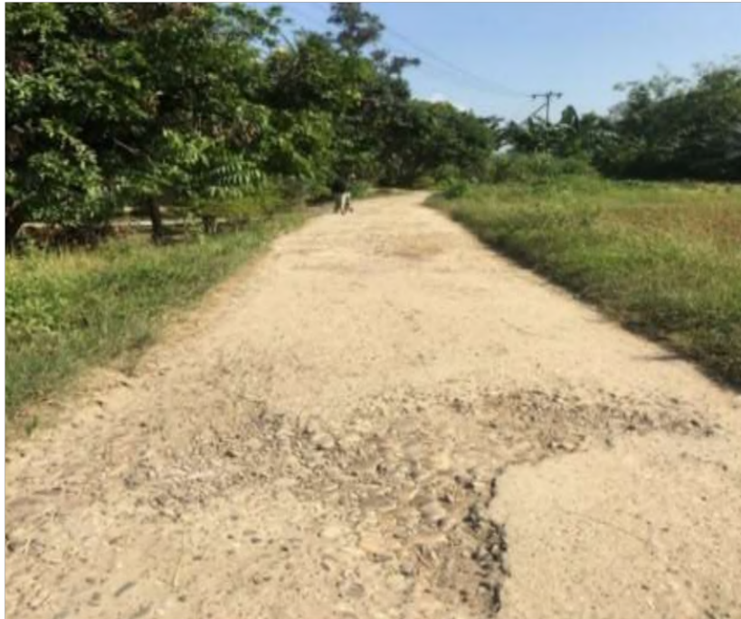
Gambar 4. 10 Kerusakan Jl. Bodi ( dokumentasi lapangan )
