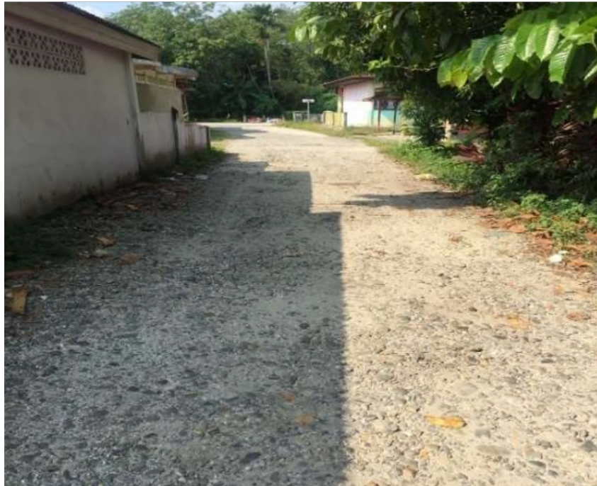
Gambar 4. 3 Kerusakan Jalan Saddam Husein ( dokumentasi lapangan )
