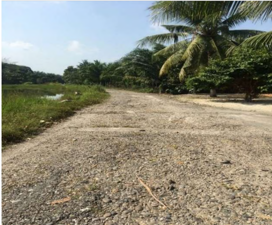
Gambar 4. 5 Kerusakan Gg. Mamutui 4 ( dokumentasi lapangan )
