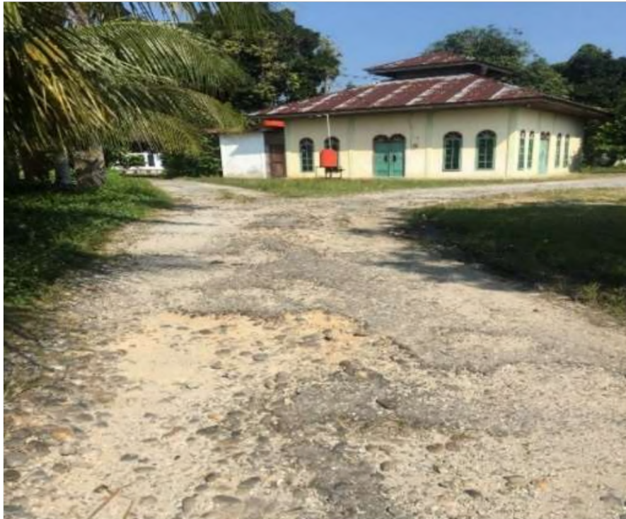
Gambar 4. 4 Kerusakan Gg. Dusun 4 ( dokumentasi lapangan )
