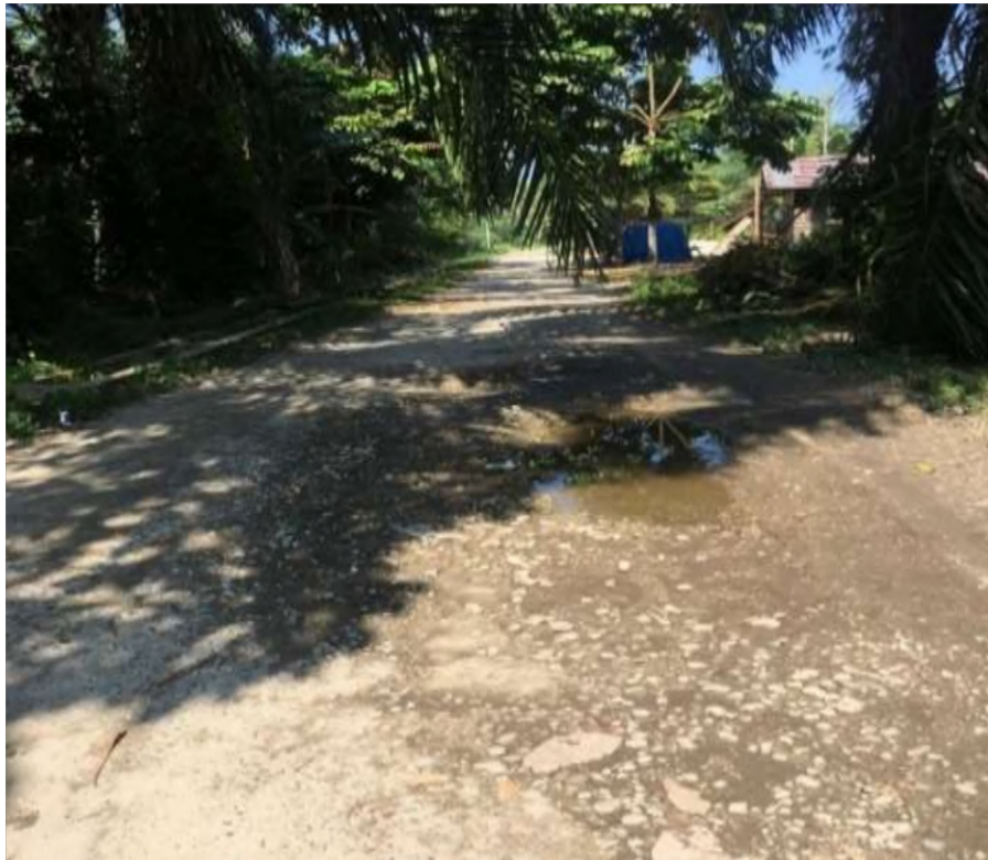
Gambar 4. 6 Kerusakan Jl. Irian ( dokumentasi lapangan )
