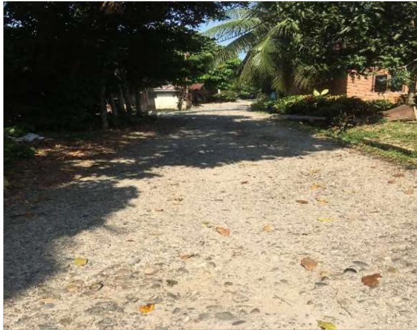
Gambar 4. 1 Kerusakan Jalan Subanglan ( dokumentasi lapangan )
