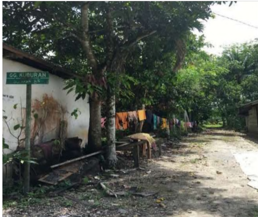
Gambar 4. 8 Kerusakan Gg. Kuburan ( Dokumentasi Lapangan )
