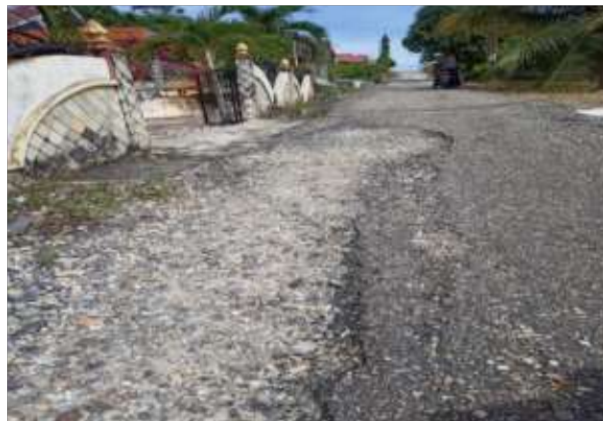
Gambar 4. 2 Kerusakan Gang reformasi 1 Sumber:Dokumentasi pribadi
